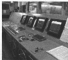
LNG Engine Room Automation
